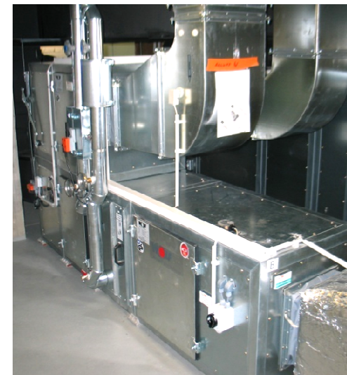
Wentylacja mechaniczna z odzyskiem ciepła
